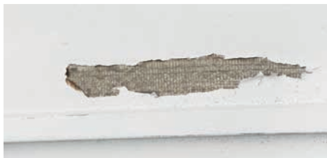
Abb. 4: Abblättern eines Alkydharzlackes auf einer verzinkten Oberfläche
