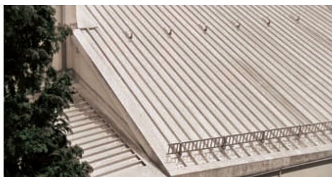
Abb. 6: ca. 20 Jahre alte Dacheindeckung (Coil-Coating, vorbeschichtet)
