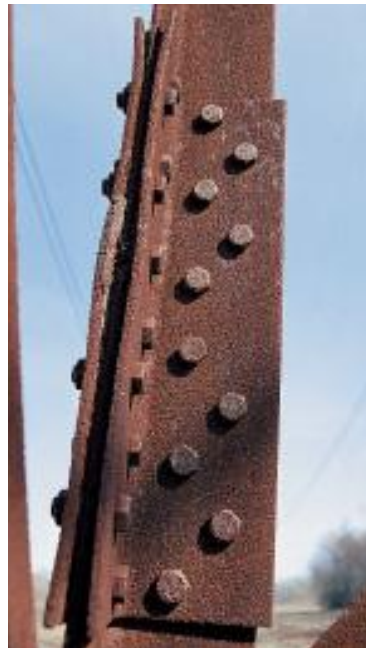
Abb. 11: Stoß des Winkels in einem Fachwerkmast. Zu große Schraubenabstände bewirken auftreibenden Rost.
