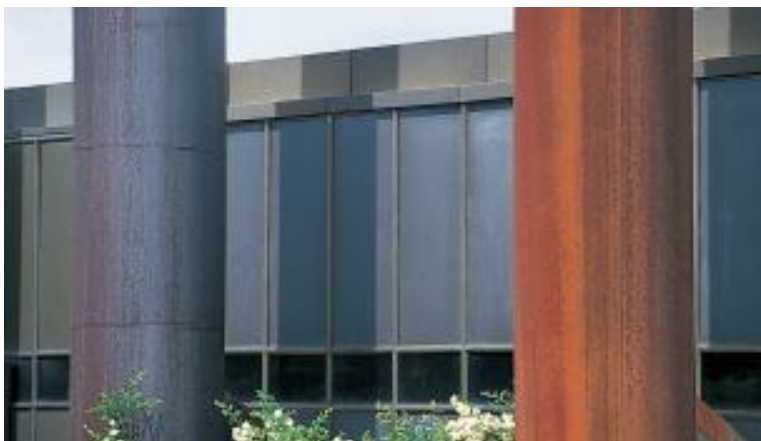
Abb. 5: Ausschnitte von zwei Industrieschornsteinen. Der linke wurde vor längerer Zeit errichtet. Er hat seine endgültige Färbung. Der rechte Schornstein steht erst wenige Monate und weist daher noch helle Rostprodukte auf.
