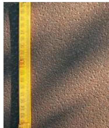
Abb. 6: Dunkelbraune, genarbte Oberfläche des direkt benetzten Wetterfesten Stahles
